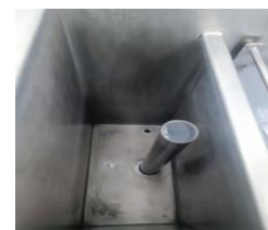
ภาพที่ 15 เครื่องแยกน้ำมันไม่มีการไหลเวียนของน้ำ
