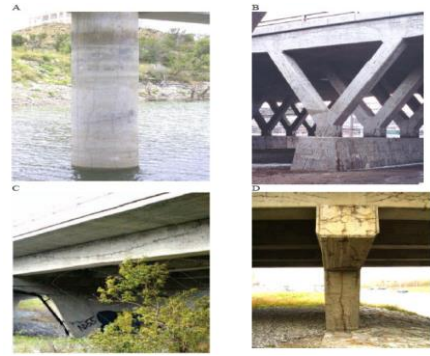
ภาพที่ 1 โครงสร้างสะพานที่เกิดการแตกร้าวเนื่องจากปฏิกิริยาอัลคาไลน์ซิลิกา (ASR)
