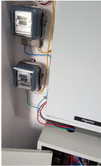
ภาพที่ 10 แสดงการติดตั้งมิเตอร์วัดปริมาณการใช้ไฟฟ้า
