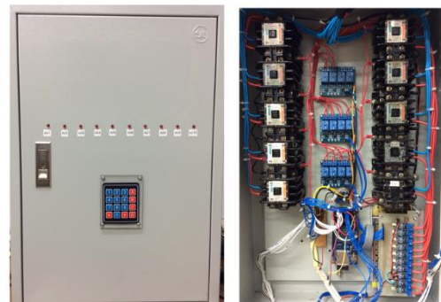
ภาพที่ 6 ภายนอกและภายในตู้ควบคุมระบบ
